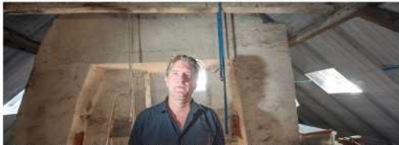
Es riecht heftig unterm Dach nach der Sanierung. Nicht nur Edgar Jablonski hat Angst um die Gesundheit. Foto: Ingo Otto
